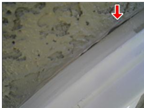
2.0 Picture 11 re-caulk top edge
