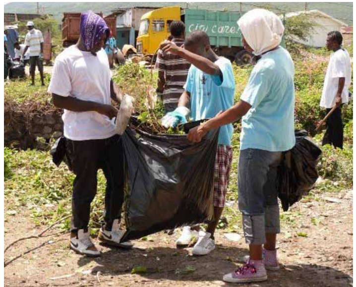
Muchos de los drenajes de Kingston están obstruidos con plantas y basura. Las tormentas muchas veces provocan que los drenajes se tapen, causando la inundación de barrios enteros. Los Rangers organizaron jornadas de limpieza comunitaria para recoger la basura y quitar la maleza. Foto: CRS Jamaica.
